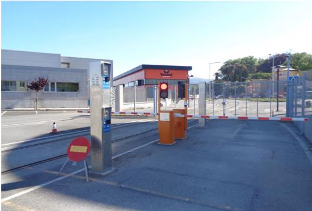
Sistema de control de accesos
